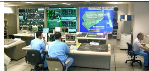
電力監視制御装置
