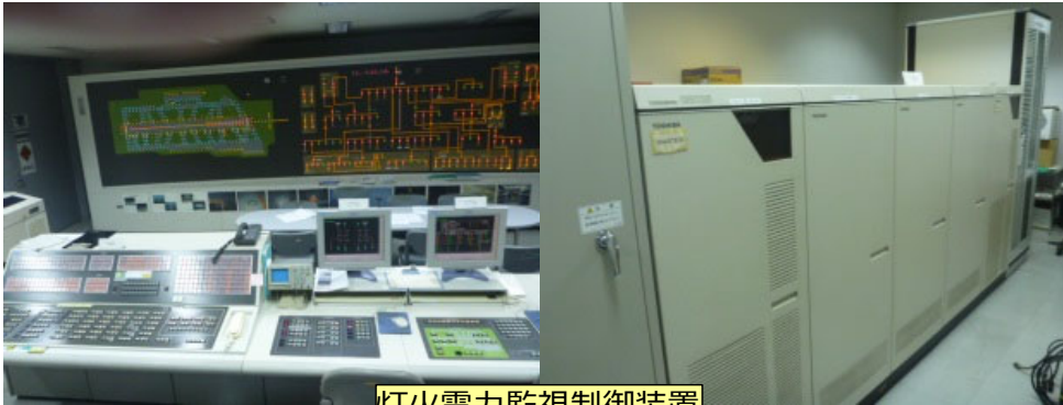
灯火電力監視制御装置
