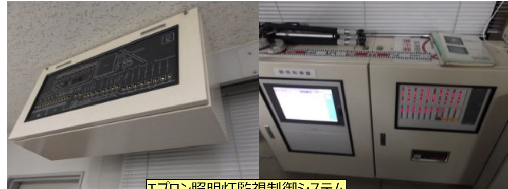
エプロン照明灯監視制御システム
