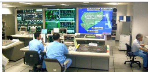
航空灯火・電力監視制御装置
