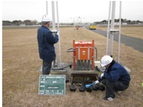
航火用変圧器
