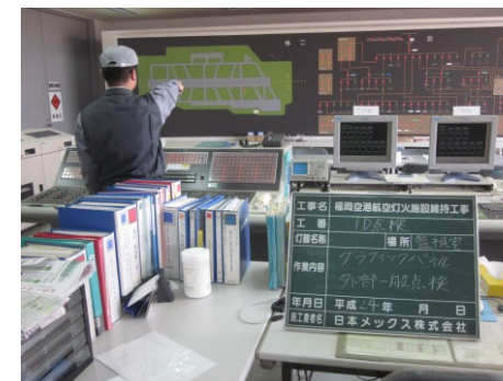
監視装置巡回点検の様子
