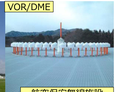
航空保安無線施設
