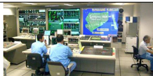
電力監視制御装置
