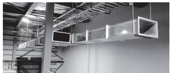
ダクトの一例
