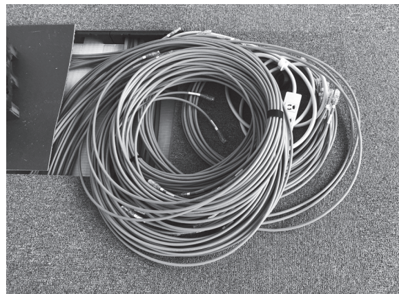
LAN ケーブルの配線事例
