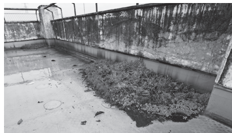
防水層に苔が生えている劣化
