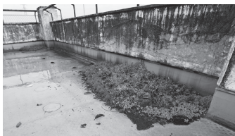
防水層に苔が生えている劣化
