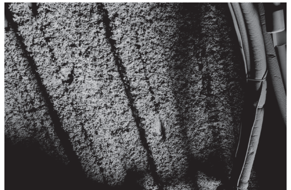
天井裏の屋根折板裏に吹付けられているアスベスト
