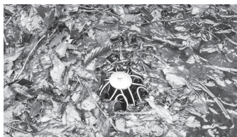
ドレンの詰まりによる水たまり発生
