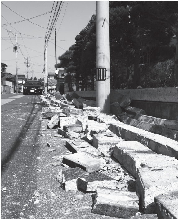
地震によるブロック塀の倒壊例
